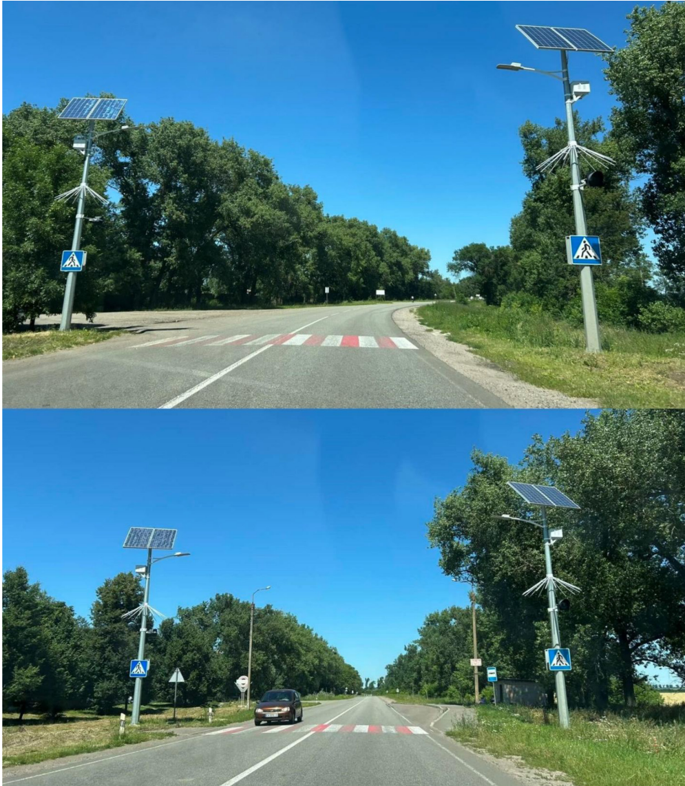
Рис. 1. Сонячні електростанції на дорогах загального користування с. Бобрик, Сумська область
