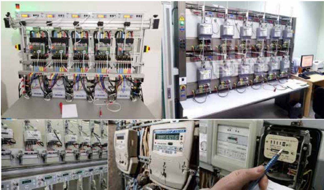
Рис. 1. Випробування лічильників електричної енергії на стенді
