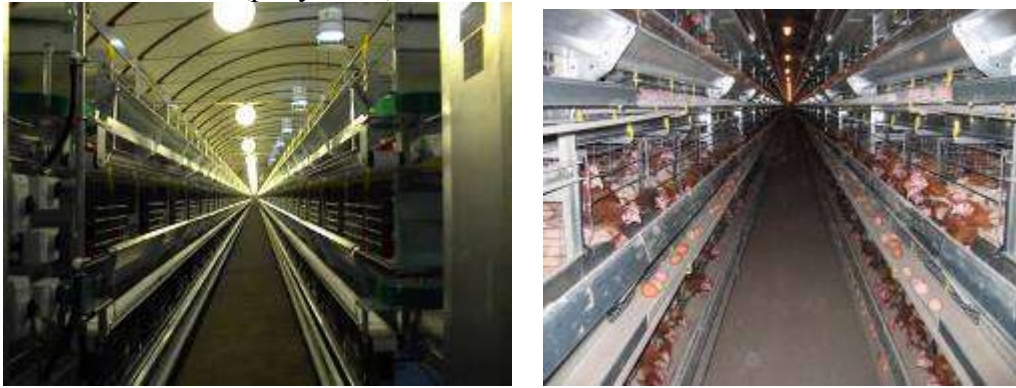
Рисунок 2 –Светильники расположены между клеточными батареями
