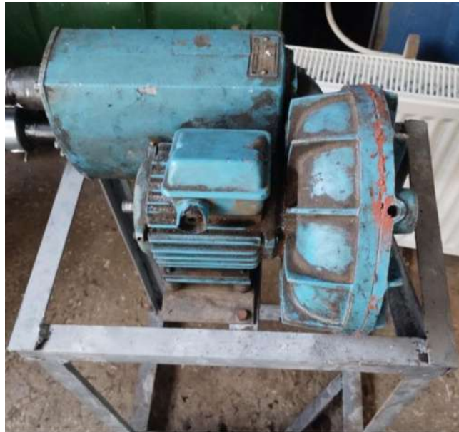
Рис. 3. Фото турбогенератора з глушником
