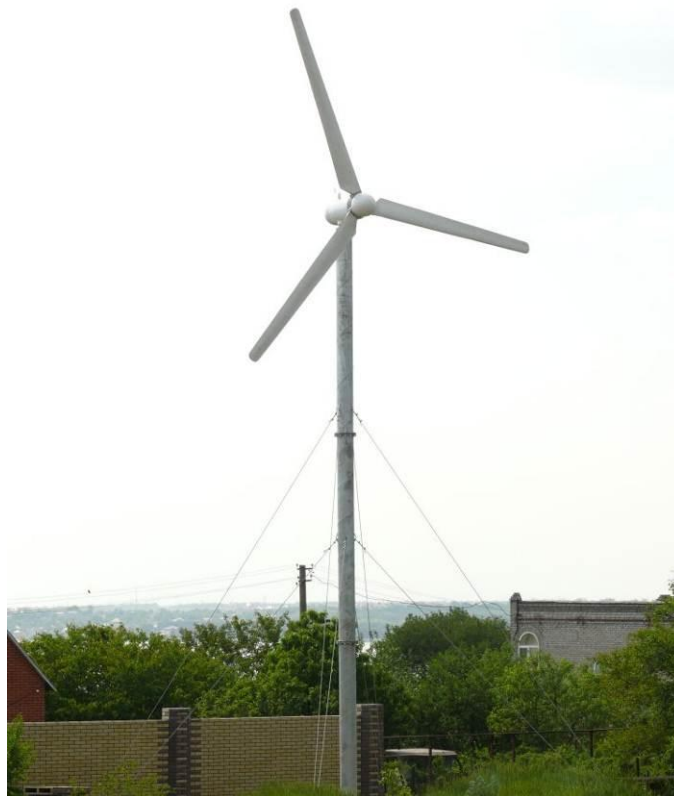
Рисунок 2 – Загальний вигляд вітроенергетичної установки
