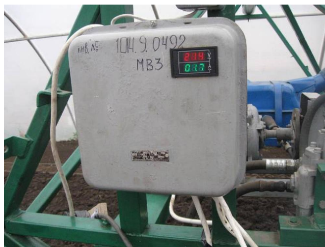
Рис. 3.18 – Розміщення цифрового вольт-амперметра АС 130-250 В в блоці-шафі агрозасобу ТДАТУ
