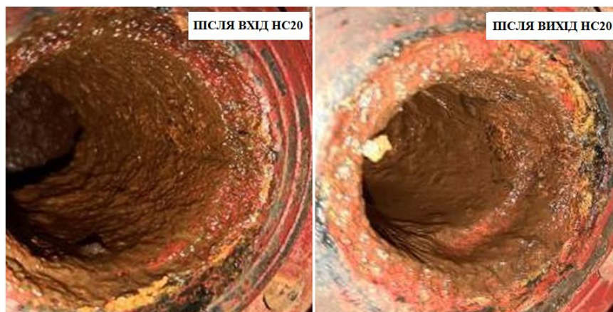
Рисунок 6. Стан відкладень на фланцях підведення води в системі водоохолодження електродвигуна НС20 після випробувань (Ліворуч - вхід, праворуч - вихід).
