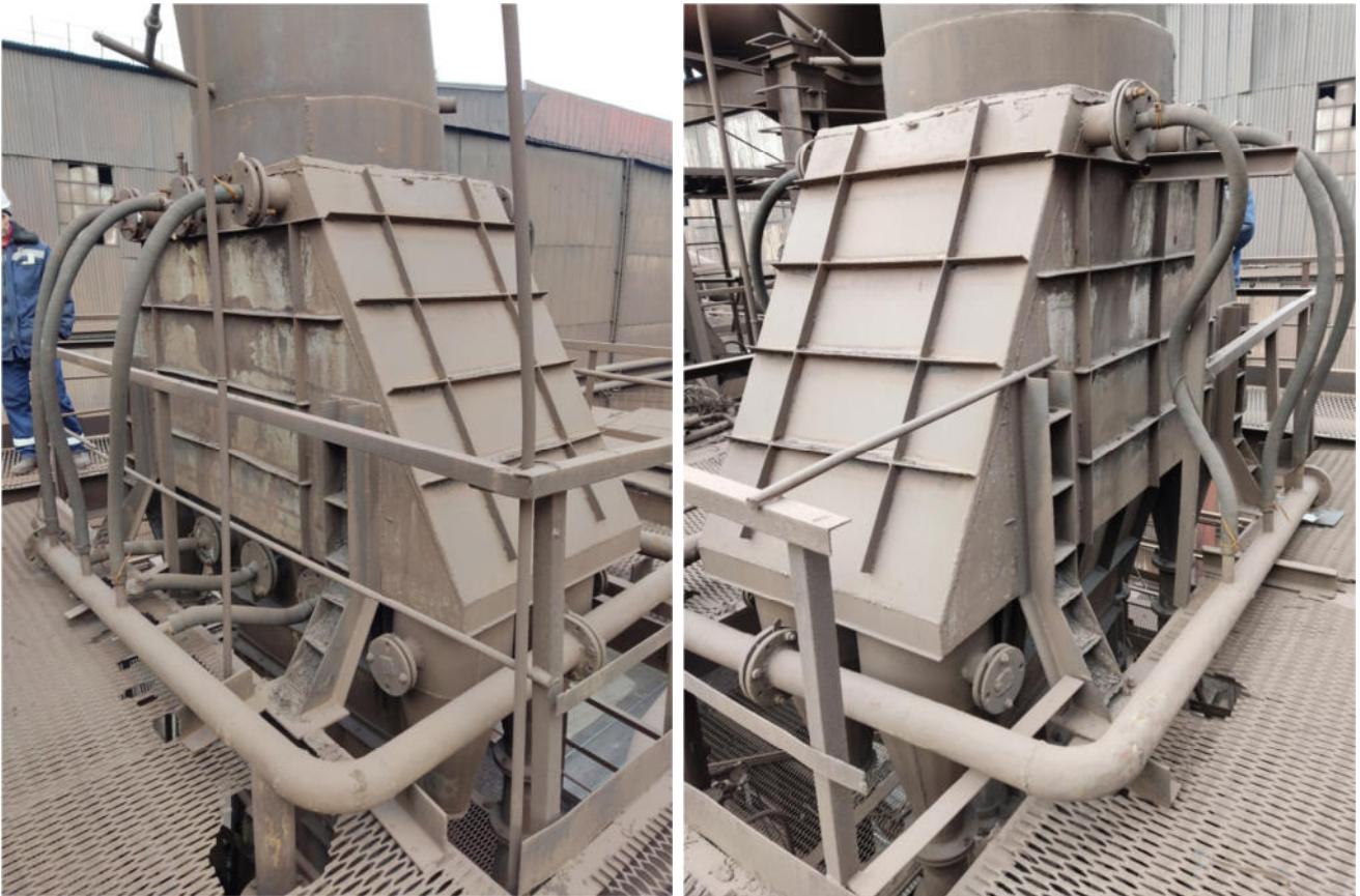
Загальний вигляд камери розпилу мокрого газоочищення
