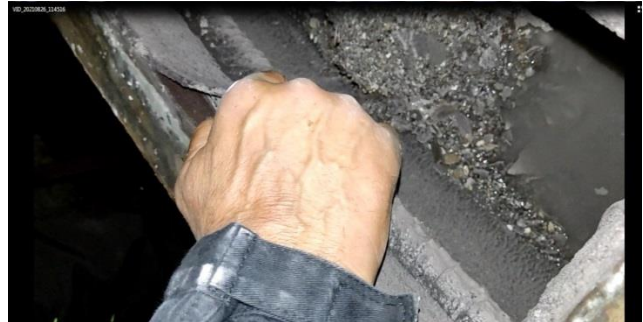
Зняття відкладень з бокової вертикальної стінки оглядового вікна подаючого трубопроводу
