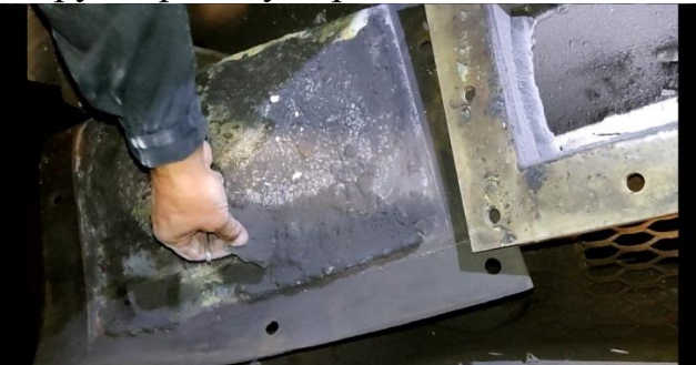
Зняття відкладення з гумової прокладки
