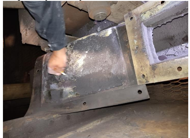
Відкладення на гумовій прокладці оглядового вікна
