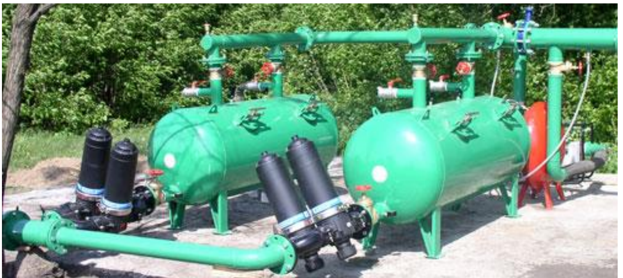
Рисунок 5 – Загальний вигляд фільтрувальної станції системи краплинного зрошування.
