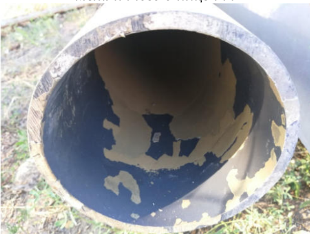
Мал. 6. Відкладення на подаючій трубі
