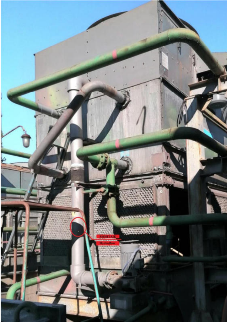
Мал. 11. Місце монтажу приладу
