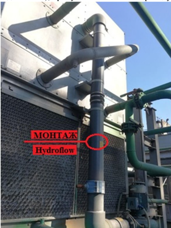
Мал. 10. Місце монтажу приладу
