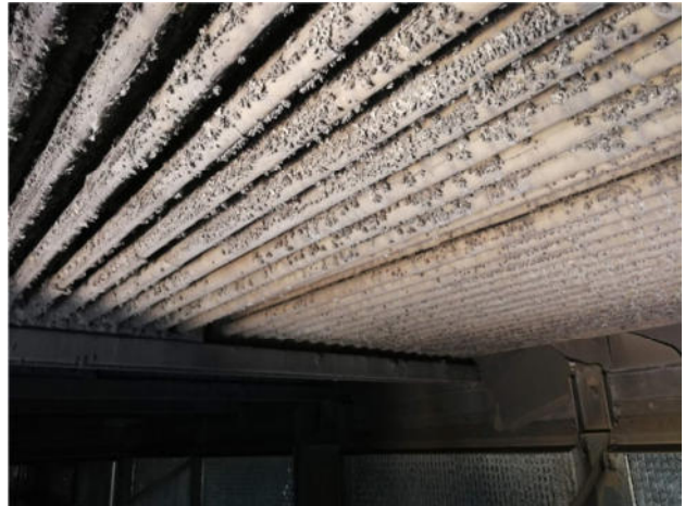
Мал. 3. Відкладення на трубках охолодження тосо́лу
