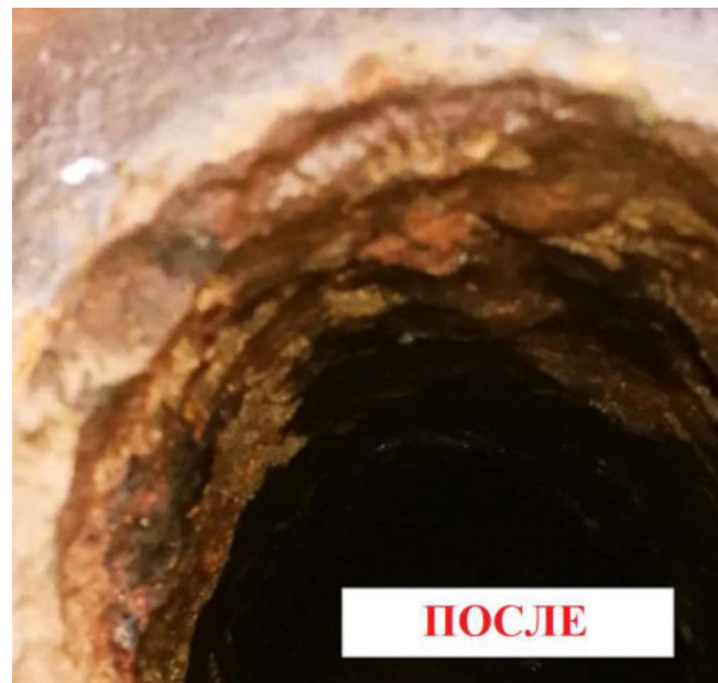
Рис.21. Элемент «В», хрупкая структура отложений с частично вымытыми кальцитами, вмятины частично раскрыты и разрушены
