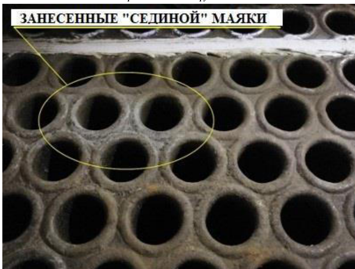
Рис.38. Покрытые «сединой» «маяки» на трубной доске ОБЪЕКТА«+»
