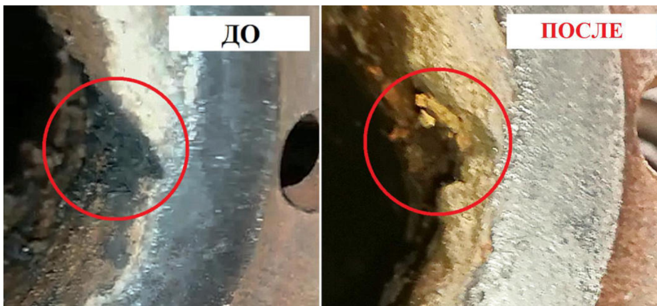
Рис.17. Сравнение состояния внутренних поверхностей контрольной зарубки на трубе подачи техводы перед ОБЪЕКТОМ«0» (Элемент «А») в начале испытаний и во время финального вскрытия (увеличенное изображение)
