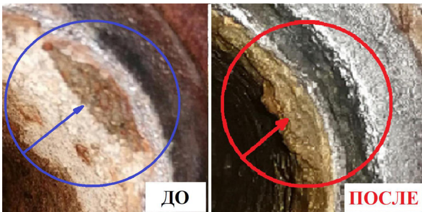
Рис.11. Увеличенный фрагмент сравнения состояния внутренней поверхности трубы подвода техводы перед ОБЪЕКТОМ”+” при стартовом и при финальном вскрытиях
