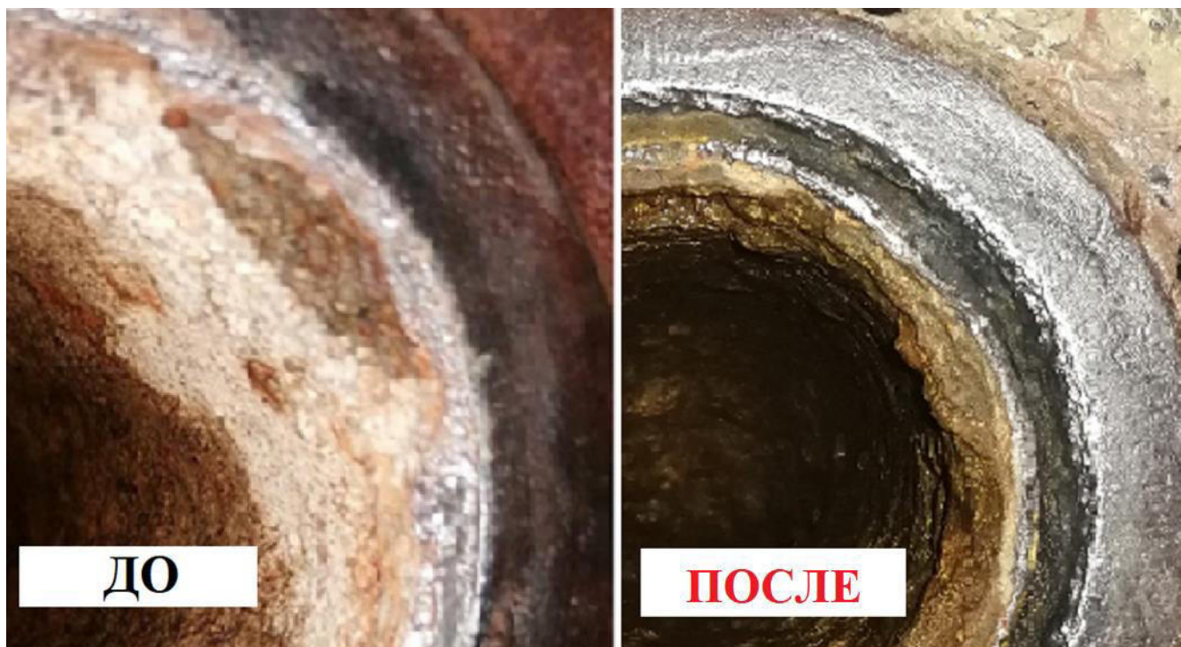
Рис.10. Сравнение состояния внутренней поверхности трубы подвода техводы перед ОБЪЕКТОМ”+” при стартовом и при финальном вскрытиях
