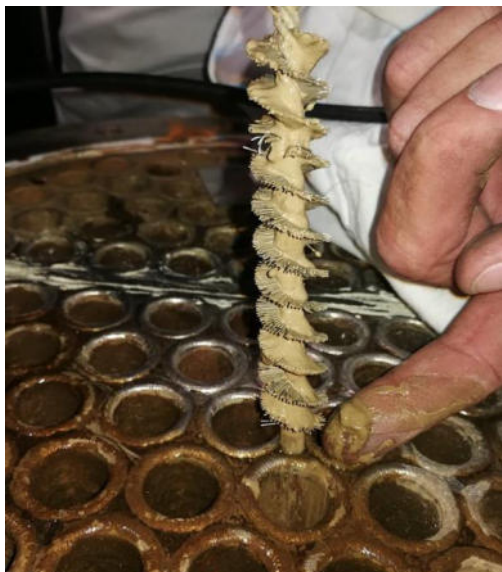
Рис.53. Отбор проб отложений с внутренней поверхности ТОТ ОБЪЕКТА«0»
