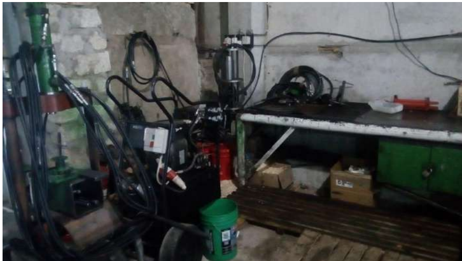
Рис. 4. Дільниця з ремонту та діагностики гідравлічного обладнання
